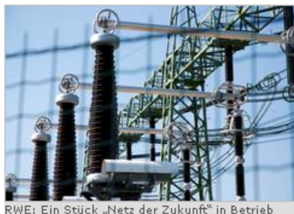
RWE: Ein Stück „Netz der Zukunft“ in Betrieb
