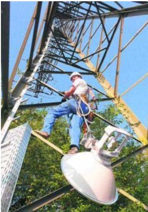
Mitarbeiter installierten die Richtfunktürschüsseln an den Sendemasten in Markdorf und Ahausen. Bilder: Keutner
