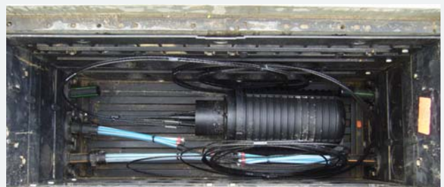
Schacht mit Mikrorohren und LWL Muffe
